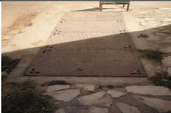
Réseau SONATEL dans l'emprise
