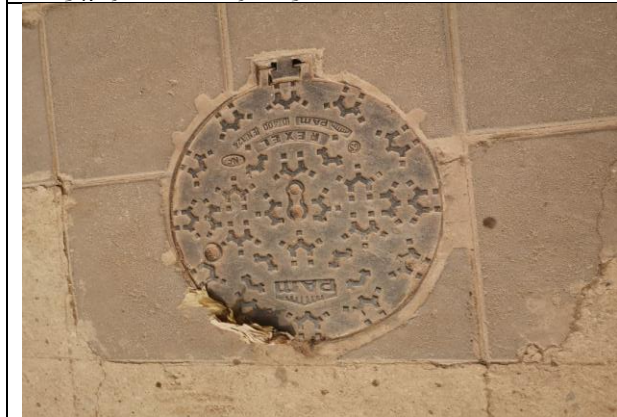
Existence de réseau ONAS X : 234719.42 ; Y : 1629010.86
