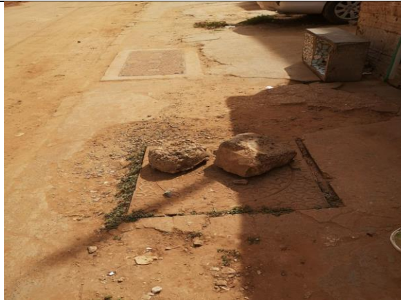
Présence de réseaux concessionnaires X : 234875.84 ; Y : 1628891.76
